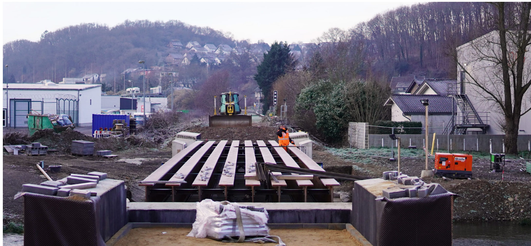
50 Tonnen Stahlträger lieferte der ArcelorMittal Stahlhandel für den Wiederaufbau einer Brücke im Ahrtal.
