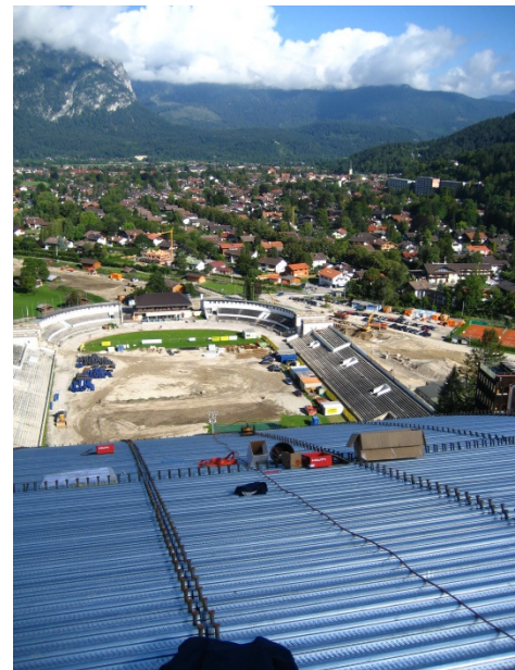
Ob Garmischer Ski-Schanze, Frankfurter Hochhaus, Berliner Parkgarage oder Münchner Altbau: Cofrastra hat viele Einsatzbereiche
